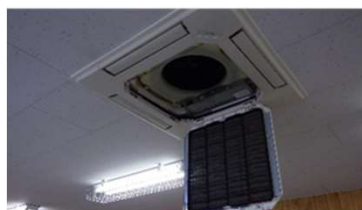
フィルタ入替前 (ロングライフフィルタ)
