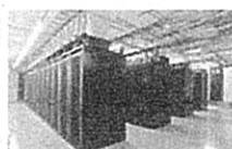
データセンター(外気取入)
